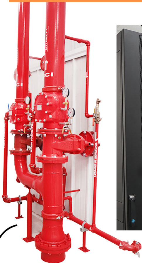
Sistema Contra Incendios
